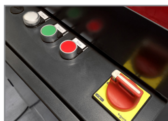
PANNELLO DI CONTROLLO CONTROL PANEL
